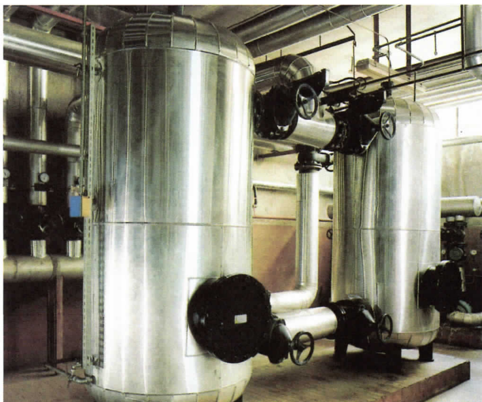
Milano I.A.C.P. - Viale Ca' Granda - Impianto termico - Centrali - Assorbitori di fanghi Schermann Wasser
